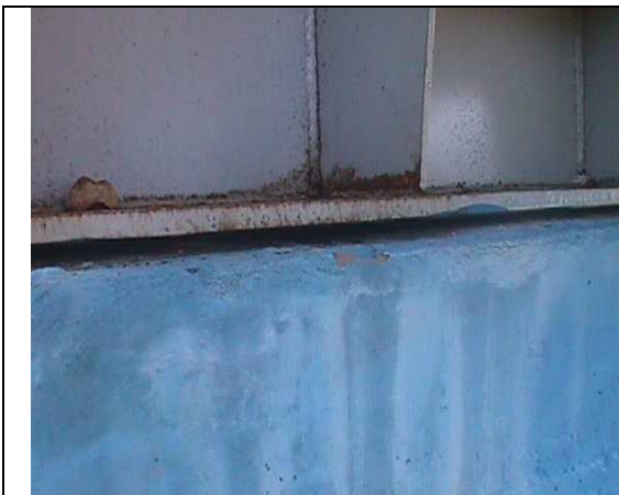
Fig. 3. Orificios sin sellar entre la base del tanque de combustible y el soporte de hormigón. Se aplicaría un mástique.
