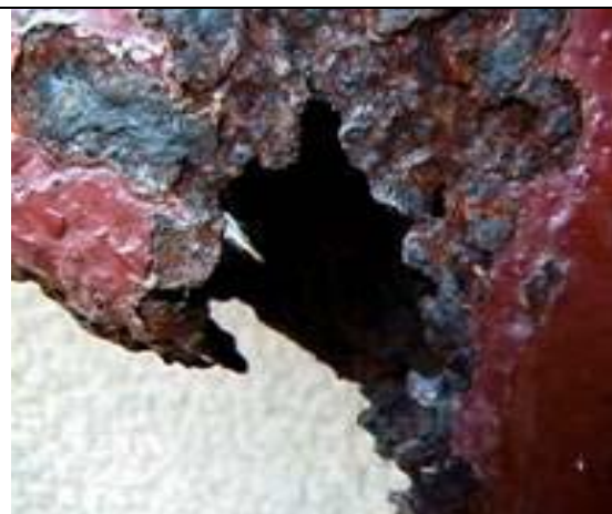
Fig. 8. Observe el daño por corrosión desde el interior del componente hueco
